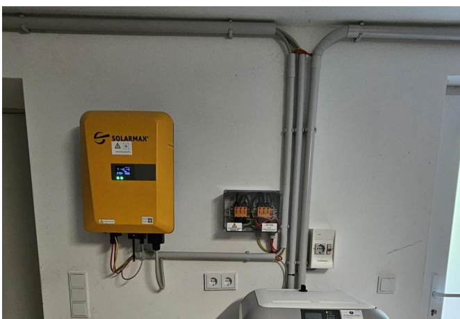
Speicher für die Solaranlage
